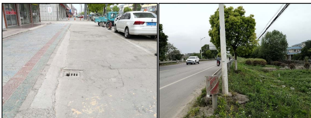
图 2.3-4 现状路基排水状况
